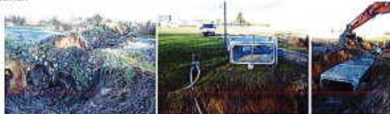
Dépose de l'ancien busage et mise en place des cadres en béton
